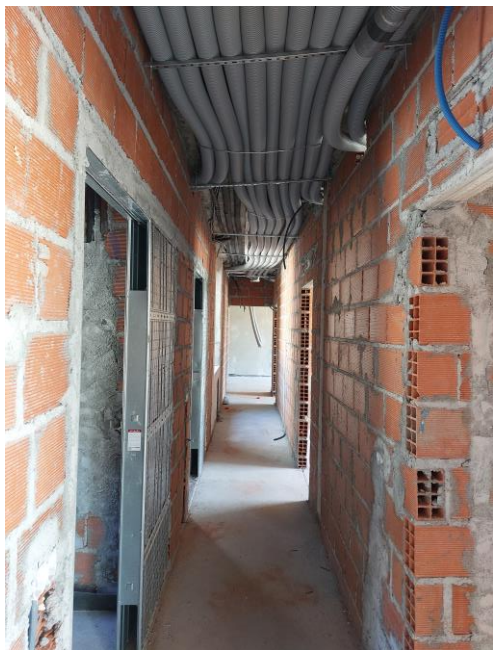
1. Condutas de ventilação pelo corredor
