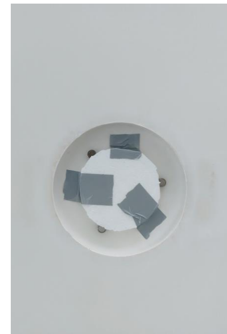
4. Vista da válvula de entrada/saída de ar
