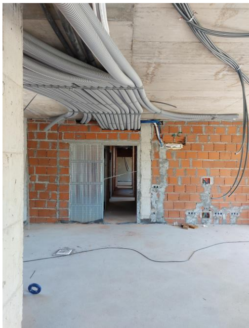
2. Condutas de ventilação sala
